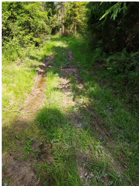
Obr.11: Nutnosť spevnenia prístupovej cesty na podmáčanom stanovišti
